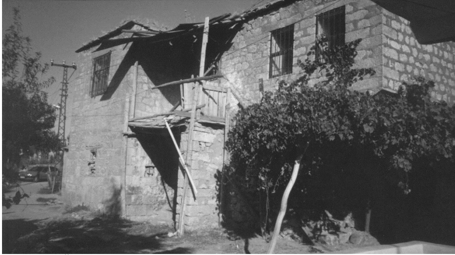
Zekeriya Üzülmmez'in iki katlı taş yapılı evinin yıkık hali. Yıl:2004 Bu yapı sonradan yeni sahiplerince yıkılarak yerine beton bina yapmıştır.
